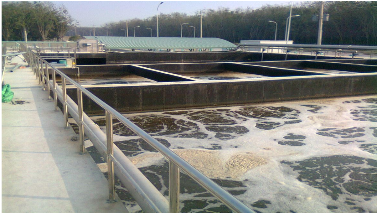
Hình VI.4. Bể Arotank trong hệ thống XLNT
