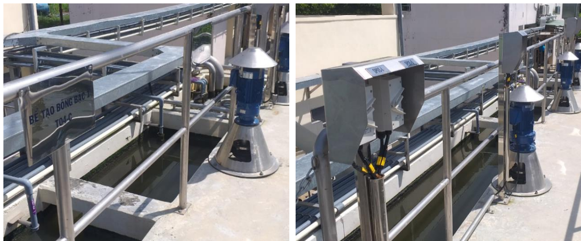
Hình 2. Bể keo tụ tạo bông bậc 1 – Giai đoạn 2
