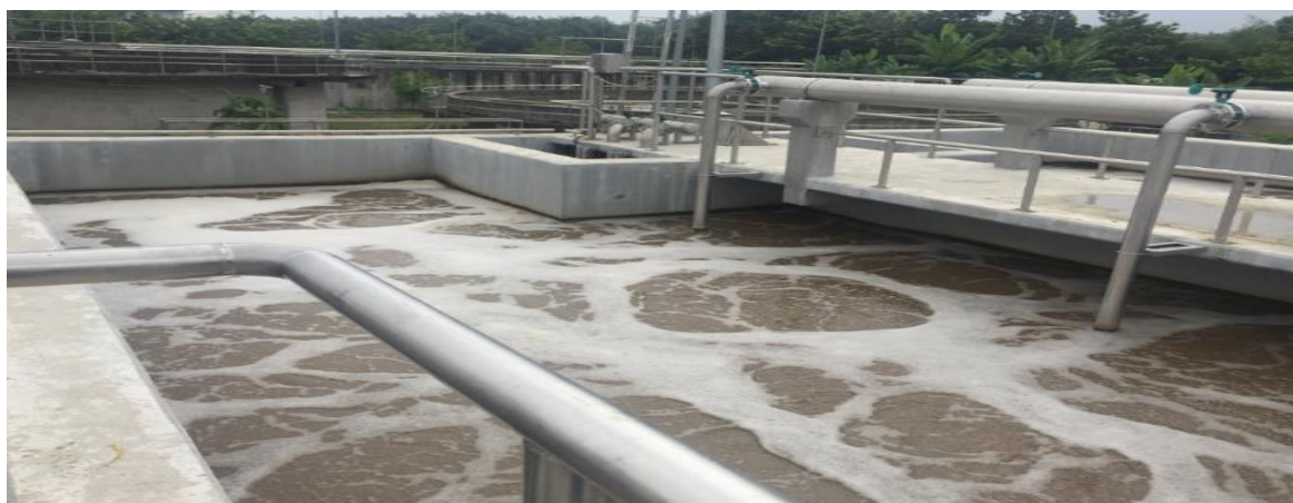
Hình 3. Bể aerotank giai đoạn 2
