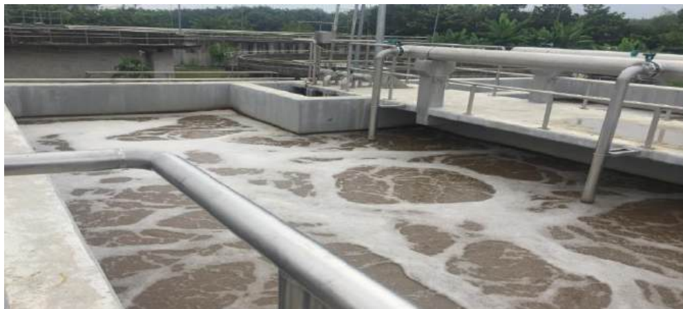
Hình 3. Bể aerotank giai đoạn 2
