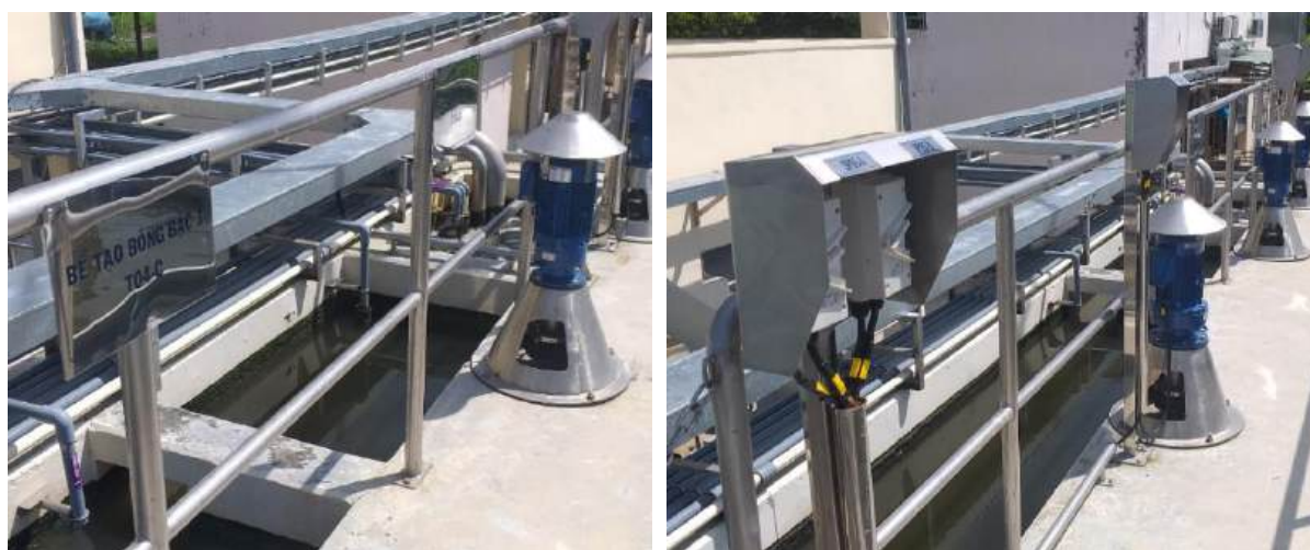
Hình 2. Bể keo tụ tạo bông bậc 1 – Giai đoạn 2
