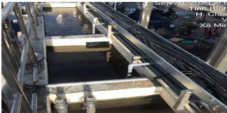
Hình 5. Cụm bể keo tụ - tạo bông giai đoạn 2
