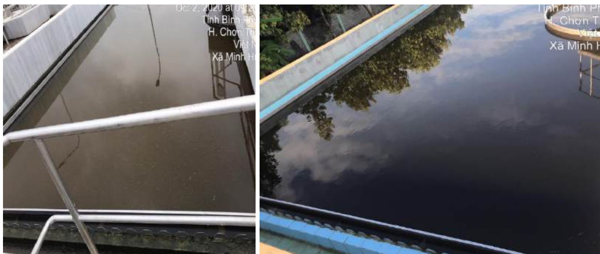
Hình 4. Bể lắng bùn sinh học giai đoạn 2
